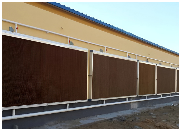
Rys. 5. Panele ewaporacyjne montowane na ścianie budynku inwentarskiego (fot. www.airmakecooling.com )
