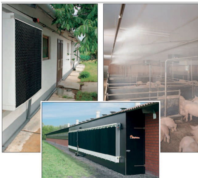
Systemy chłodzenia stosowane w chlewniach (źródło: Big Dutchman)
